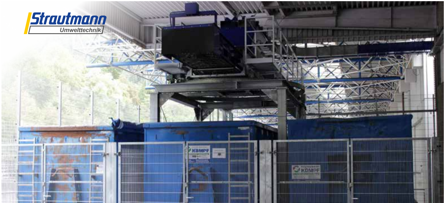
Automatische Brikettverteilung auf drei Container
